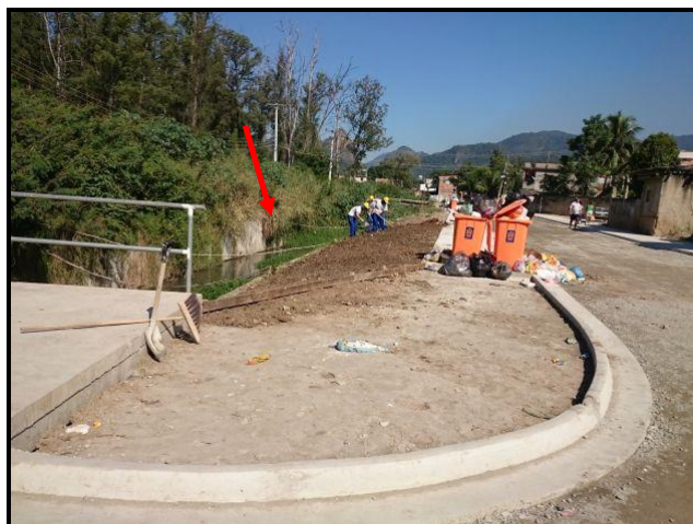
Foto 18 – Pendente a instalação de guarda corpo do outro lado da ponte "7".
