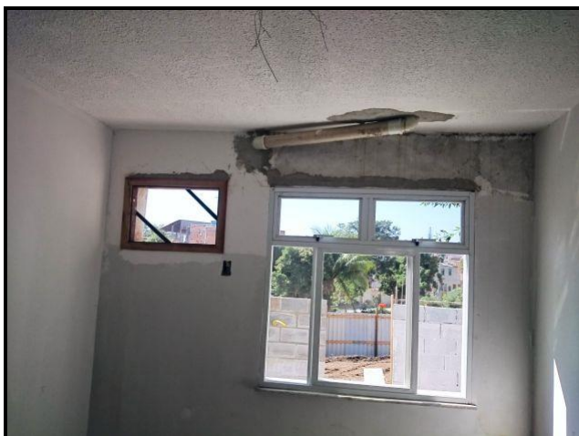
Foto 24 – Necessária instalação de acabamento em todos os pavilhões para ocultar a tubulação de esgoto aparente.
