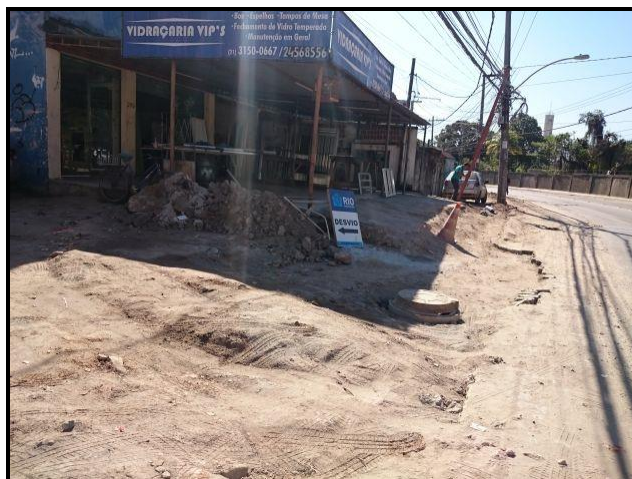
Foto 21 – Calçada da Estrada do Guerengê na altura do número 2114 carece de pavimentação.
