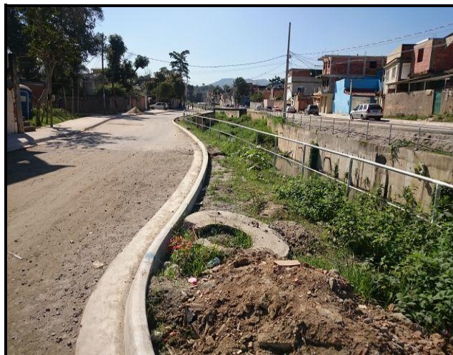
Foto 16 – Avenida do Canal permanece pendente de pavimentação.
