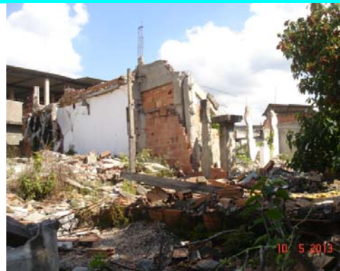
Figura 37 – Parte de casa demolida.
