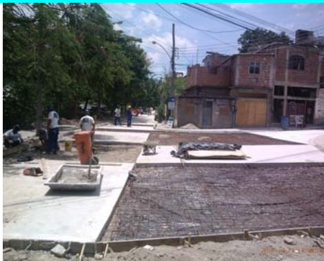
Figura 5 – Rua Onil Machado Gitahy onde estão sendo executados os radiers para a sua pavimentação.
