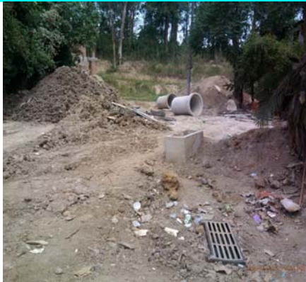
Figura 21 – Trecho da Rua Nossa Senhora de Fátima com infraestrutura executada, sem pavimentação.
