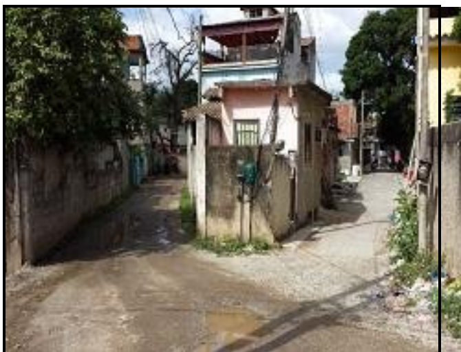
Figura 16 – Rua Sampaio Correa, 136. Lado A (direito) concluído e lado B (esquerdo) a executar.
