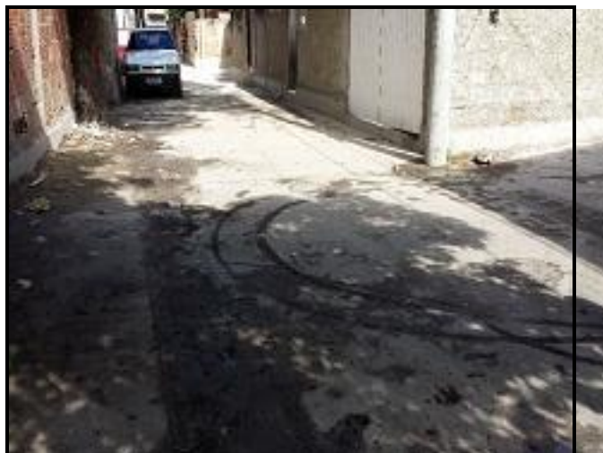
Figura 18 – Rua Verde 41. Pavimentação em concreto executada com marcas de pisoteamento e de rodas.
