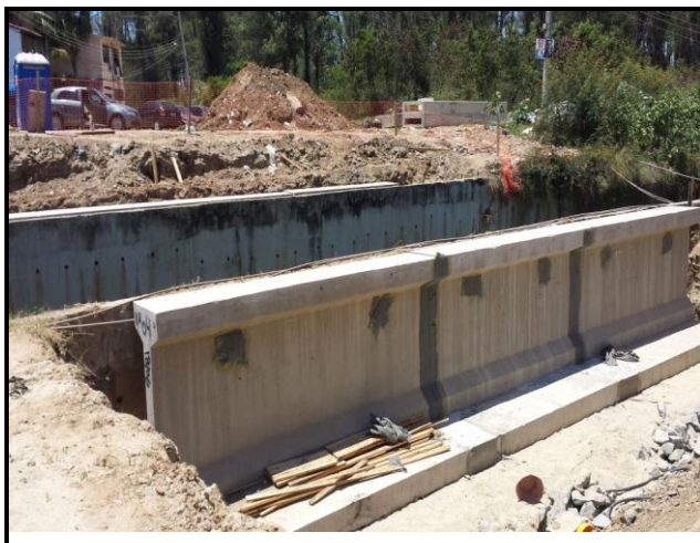
Foto 17 – Ponte “7” sendo executada para transposição de pequeno canal. O apoio do tabuleiro serve também como arrimo.
