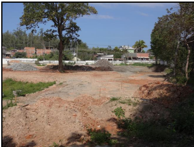
Foto 09 – Área de construção de futuras 12 casas. Efetuada a troca de solo e preparo do terreno.
