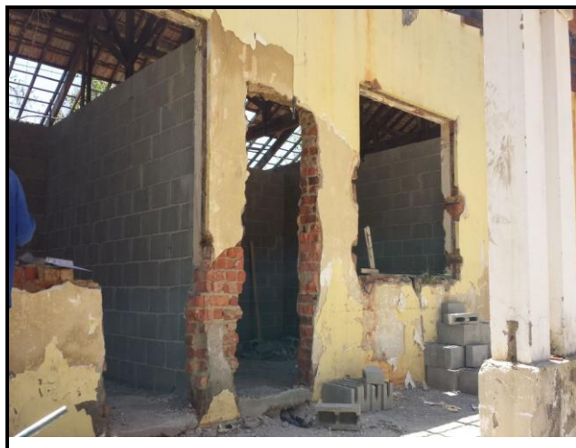
Foto 06 – Pavilhão com alvenaria divisória suspensa, iniciando os lançamentos das lajes pré-moldadas, instalações hidro-sanitárias executadas, instalações elétricas iniciadas.
