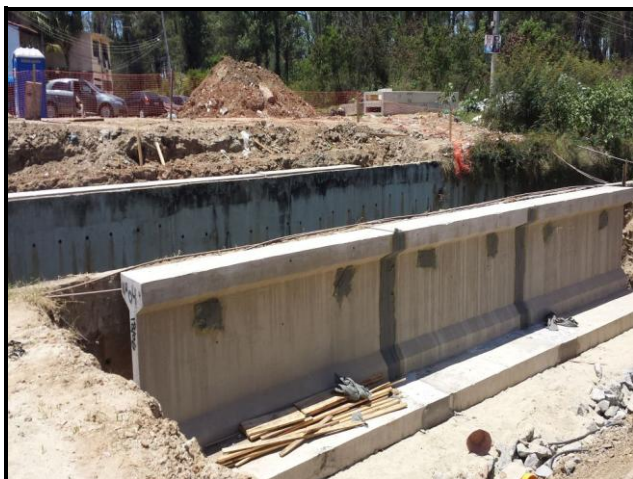
Foto 15 – Ponte “7” sendo executada para transposição de pequeno canal. O apoio do tabuleiro serve também como arrimo.
