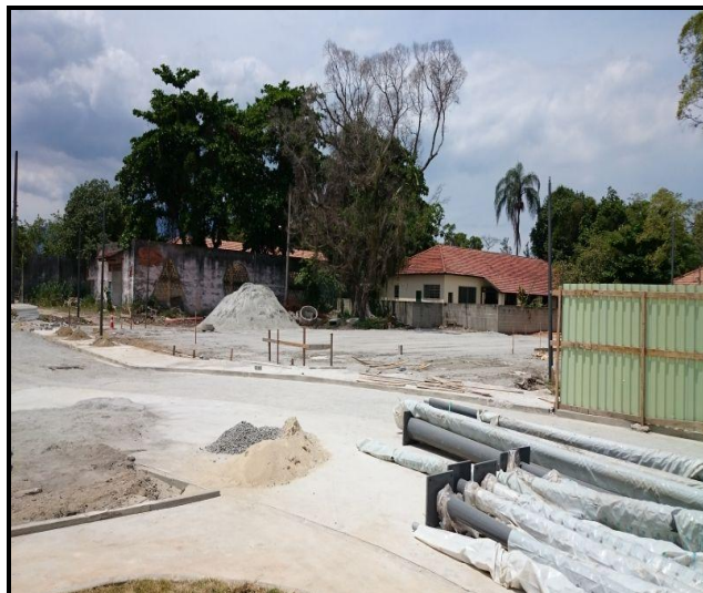
Foto 14 – Início de construção da praça 10, realizando-se preparo do terreno com uso de pó de pedra e areia.
