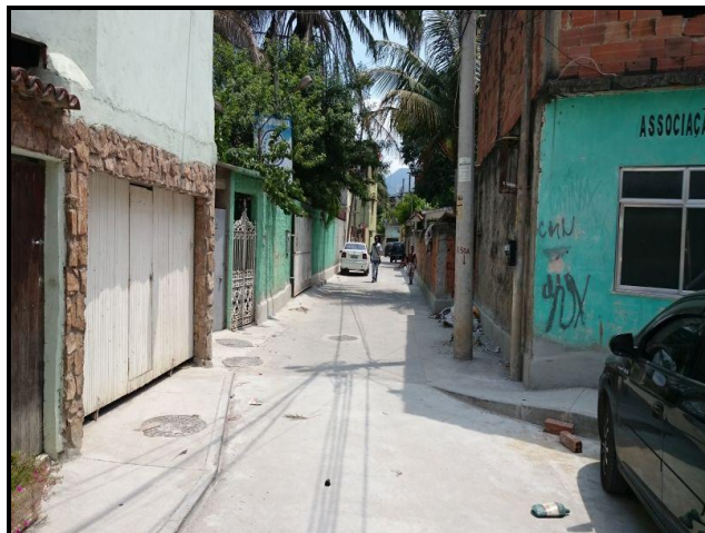
Foto 22 – Estrada do Guerengê nº 21, beco 12 A, finalizado, incluindo instalações de água e esgoto.
