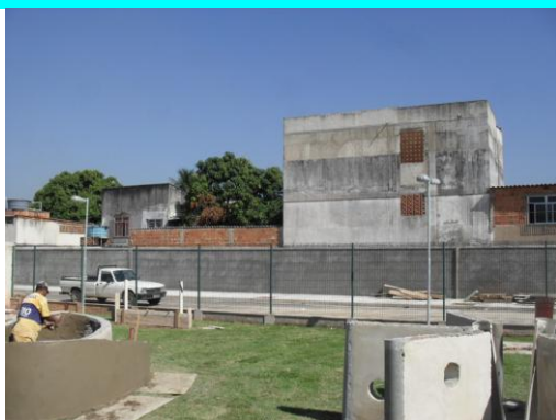
Figura 3 – Vista atualizada do gradil e muro ao fundo, já incluindo mobiliário da área de recreação.
