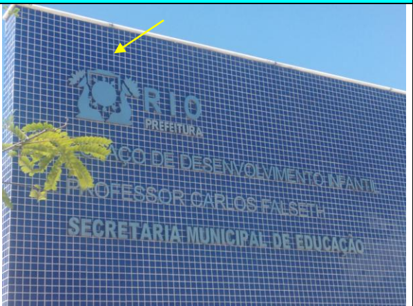
Figura 16 – Falta parte de cima do brasão da Prefeitura.
