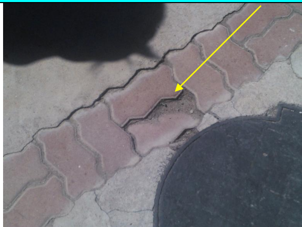
Figura 15 – Piso mal acabado no pátio da entrada principal, podendo ocasionar acidentes.
