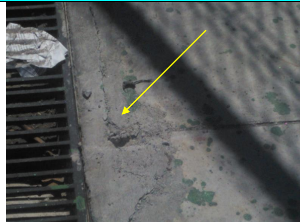
Figura 12 – Furo mal feito para prender o portão da garagem, ocasionando transtorno ao fechar.
