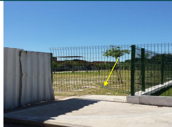
Figura 10 – Grade danificada do lado esquerdo inferior ao portão do estacionamento.
