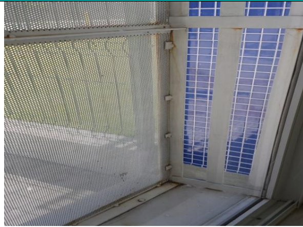
Figura 07 – Ferrugem na grade da janela da diretoria.
