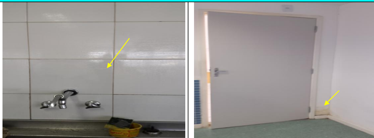
Figura 03 – Infiltração na parede, em cima da pia da cozinha, evidenciada pelo escurecimento de parte dos azulejos.
