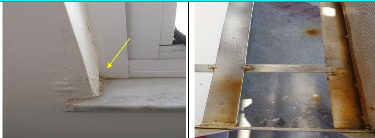
Figura 05 – Infiltração no lado esquerdo inferior da janela da sala da diretoria.
