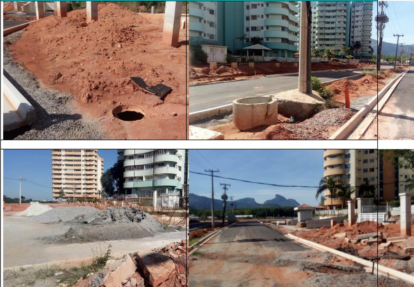
Fotos 5, 6, 7 e 8 – Diversos serviços inacabados e estocagem de materiais sem proteção. Os trechos inacabados podem representar risco de acidente.
