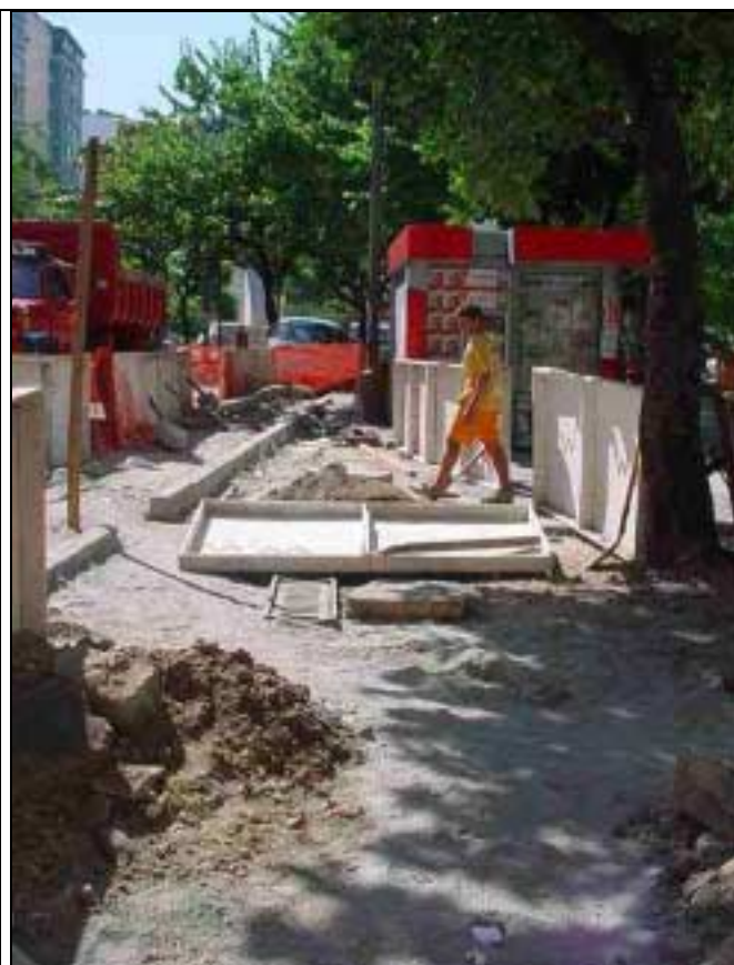
Figura 7 – Recomposição de passeio e meio-fio junto à rua São Salvador registrada na visita anterior.
