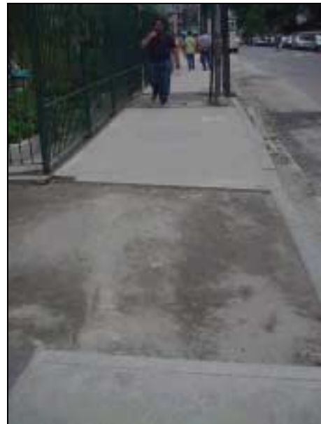
Figura 19 - 3ª Visita 12/2003 – Pendente a recomposição dos acessos de garagem .
