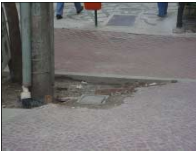
Figura 20 - Detalhe de passeio não acabado. Rua Marques de Abrantes (lado par) prox. a Rua Clarice Indio do Brasil.
