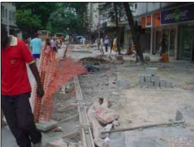
Figura 25 - 3ª Visita 12/2003 Passeio e baia de ônibus não acabados.
