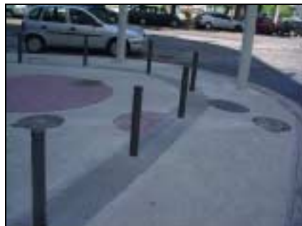
Figura 5 - 4ª Visita 03/2004 - Corte no piso entre as caixas da CET-Rio. Trecho que será refeito (Check-List).
