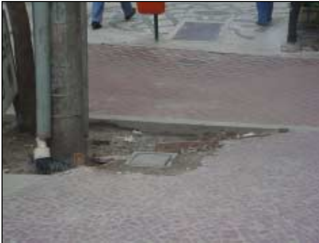
Figura 19 - 3ª Visita 12/2003 -Detalhe de passeio não acabado.
