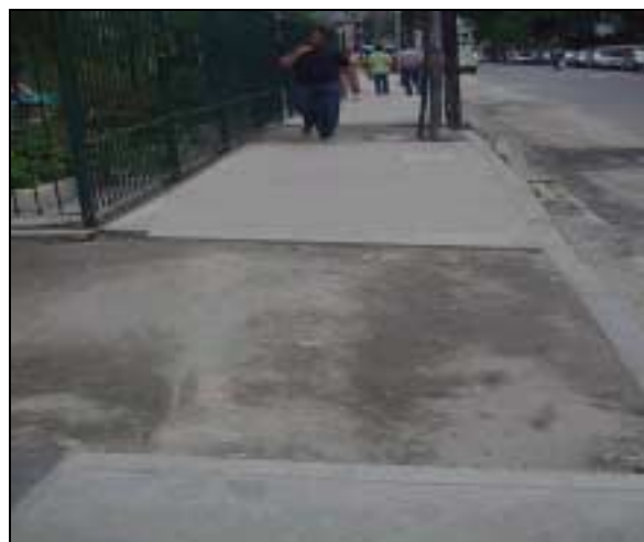
Figura 16 - 3ª Visita 12/2003 – Pendente a recomposição dos acessos de garagem .
