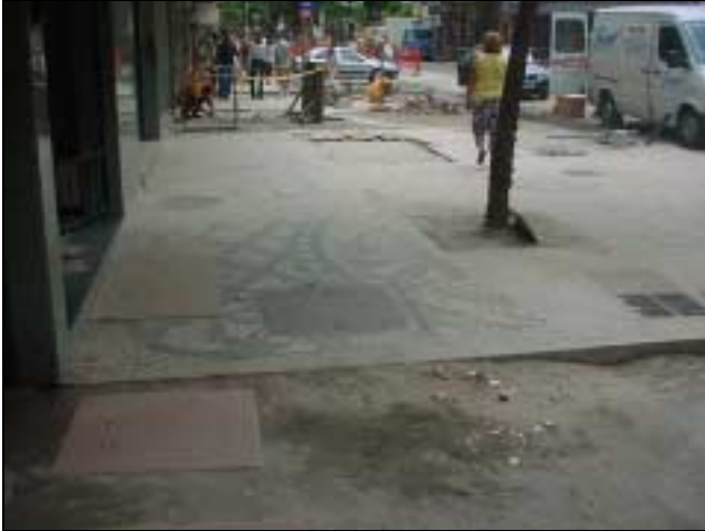
Figura 23 -3ª Visita 12/2003 - Passeios e entrada de garagem não acabados.
